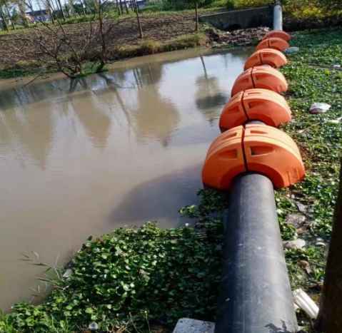
排泥管安全管理
